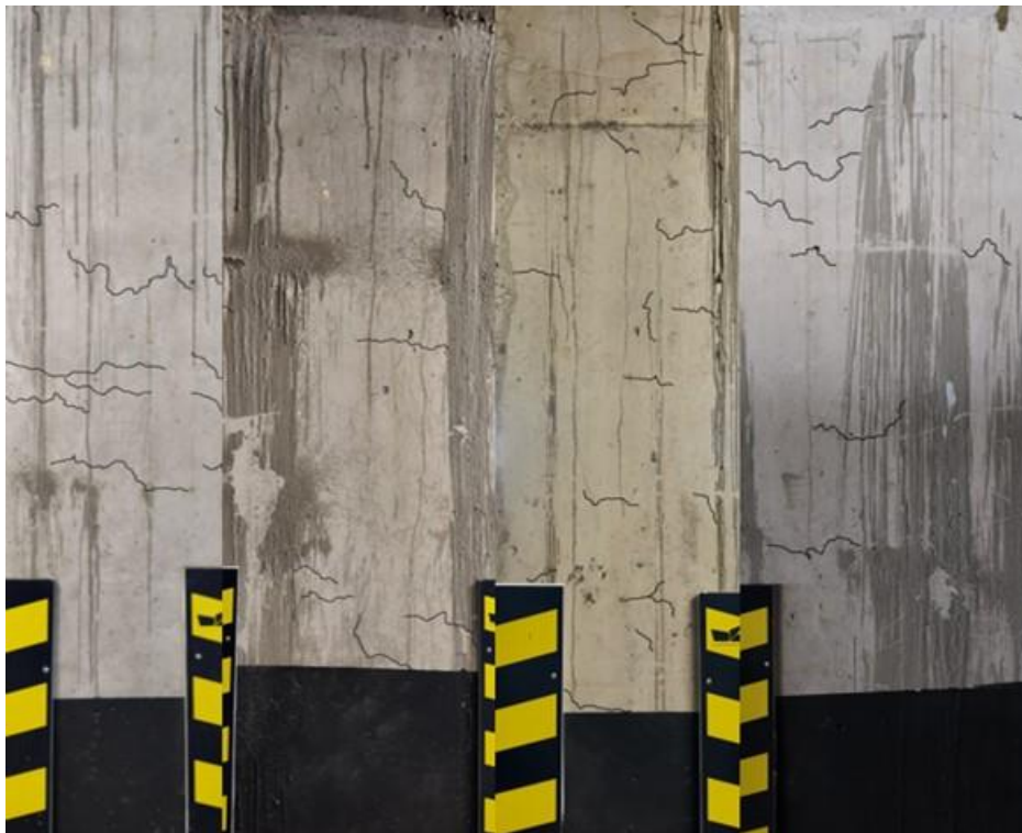
Figura 6. Imagen de compuesta generada de las cuatro caras de una columna para ubicar posición de las grietas presentes (Torres Acosta 2024).
