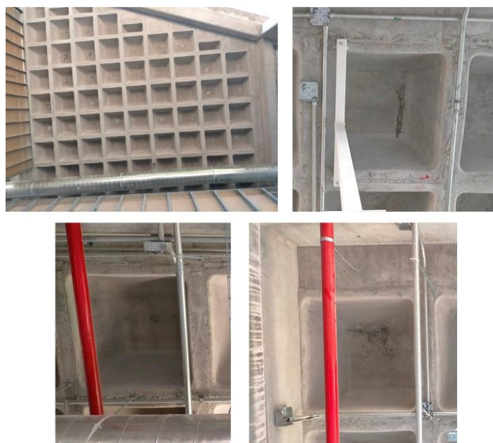
Figura 4. Patología de las grietas observadas en un edificio en construcción con losa a base de nervaduras. Fotos tomadas por autor en abril 2024.
