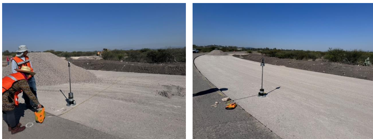
Figura 2a-b. Ejemplo de ejecución de ensayos de módulo de rigidez con el LWD.
