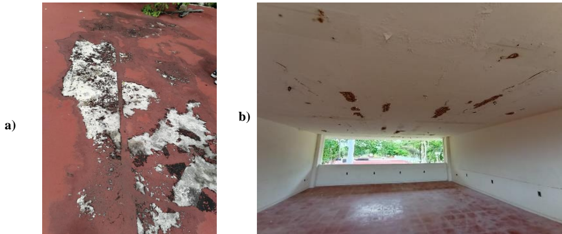
Figura 2. Daños detectados en edificio 1: a) Techo exterior, Código B5, daño por mancha de humedad y b) Parte interior de la losa de azotea, Código C3, desprendimiento del concreto resultando en la exposición del acero en la mayoría de las viguetas.
