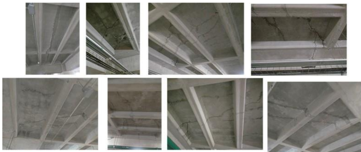
Figura 1. Patología de las grietas observadas en un estacionamiento de una plaza comercial inaugurada a fines del 2019. Fotos tomadas por autor en noviembre 2023.
