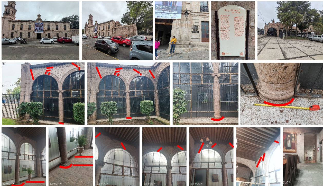
Figura 7. Vista general del sitio en estudio, donde se observan algunas grietas en los pisos, pero principalmente en los muros y columnas.
