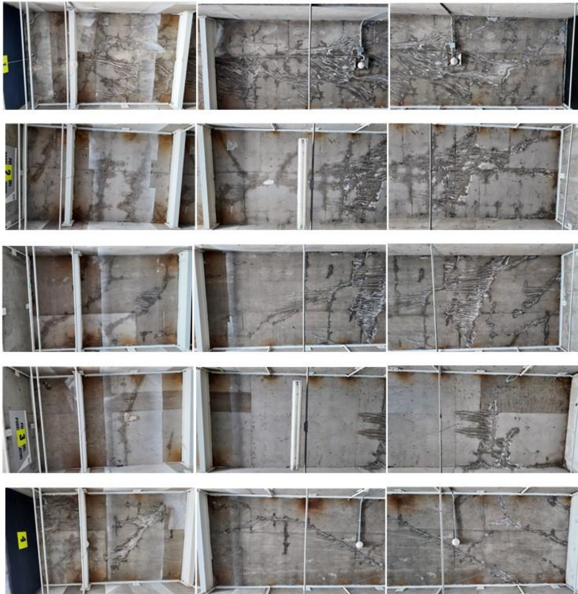
Figura 7. Imagen compuesta de una porción de losa utilizada para marcar sobre ella las grietas formadas, como capa de imagen sobre el archivo AutoCAD (Torres Acosta 2024).
